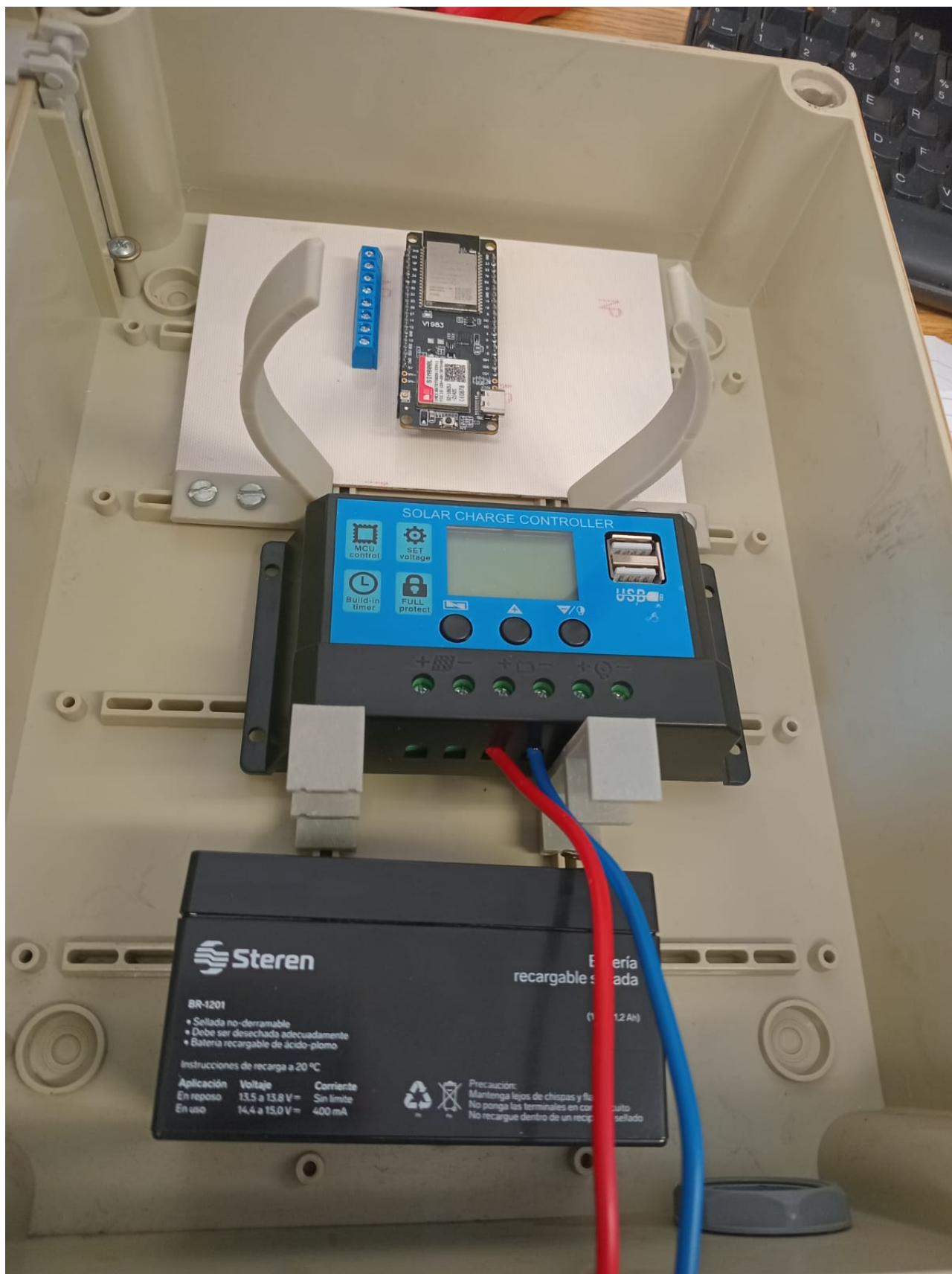
Figura 3.5: Montaje interno de la caja de registro: PCB, batería y controlador de carga solar.
