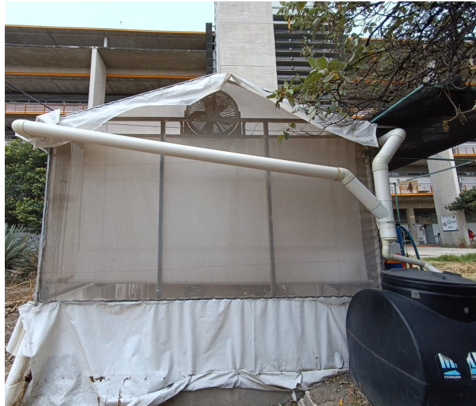
Figura 3.3: Tubería de conducción de agua pluvial y tanque de almacenamiento.
