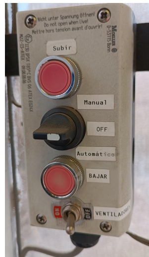
Figura 5.11: Botonera selectora de la operación del sistema de ventilación.
