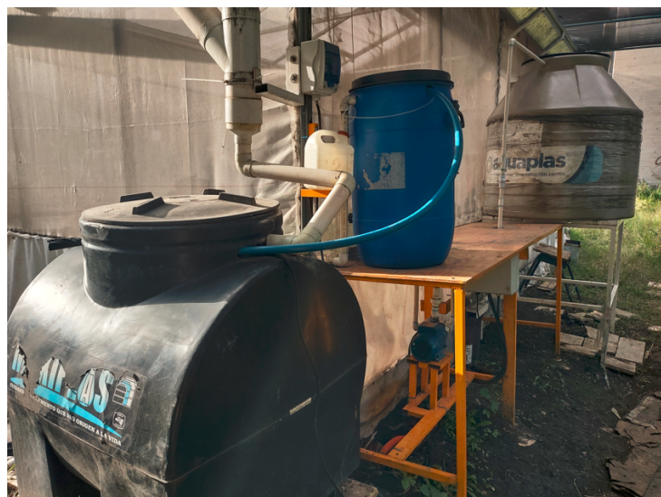
Figura 6.3: Tinacos y tambo utilizados en las etapas del Sistema de tratamiento de agua.
