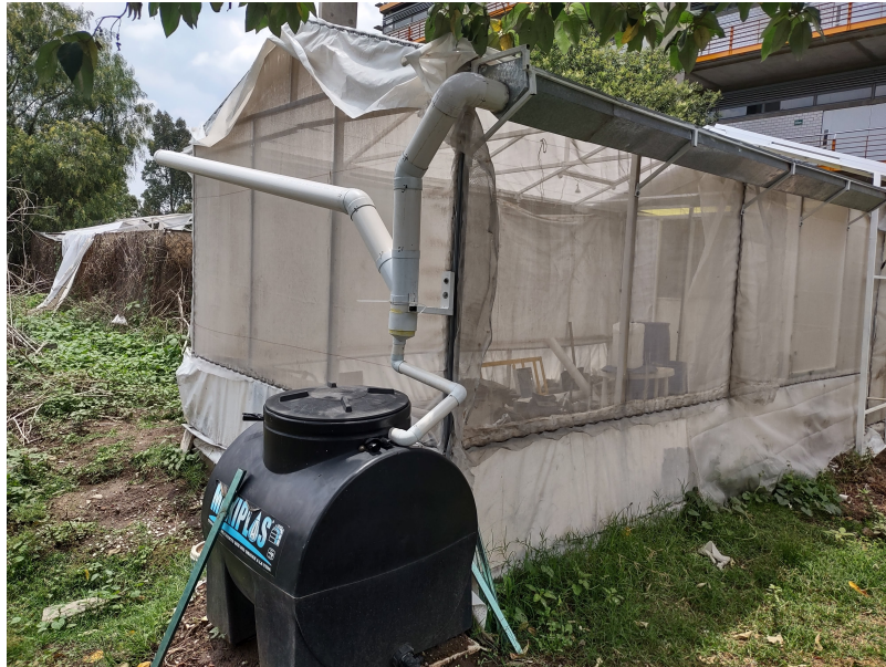
Figura 6.2: Sistema de captación y almacenamiento de agua pluvial.
