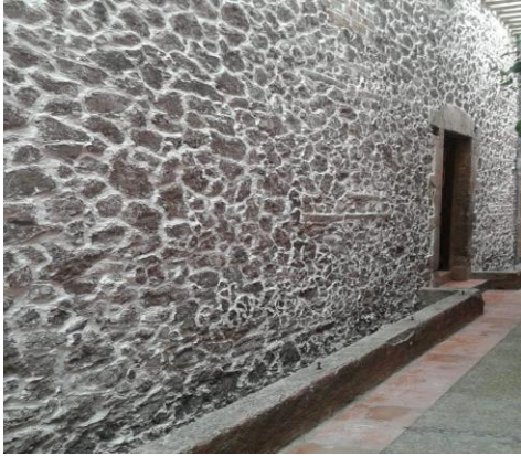
Figura 41 correspondiente a uno de los muros de la planta alta del primer patio de la Casa, ubicado en la zona de República del Salvador. Fuente perteneciente al archivo fotográfico de Jessica Mendoza (2020).
