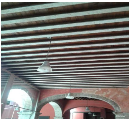
Figura 42 correspondiente al techo de la zona de la “pecera”. En este lugar el techo fue cambiado Fuente perteneciente al archivo fotográfico Jessica Mendoza (2020).
