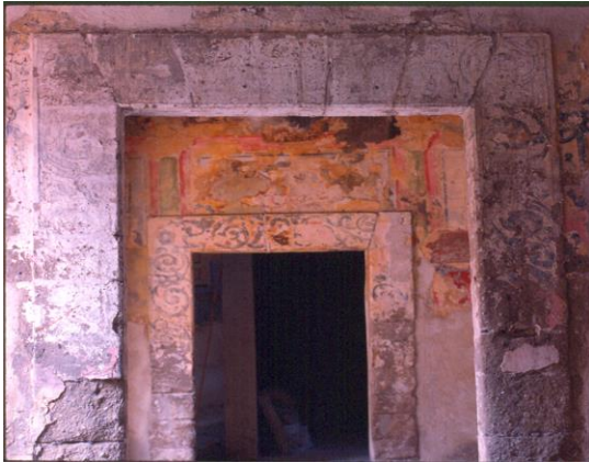
Figura 34 se puede observar como al quitar la pintura están saliendo las “cenefas” que había en Casa Talavera. Fuente perteneciente al archivo fotográfico de Gilda Cano (1987).
