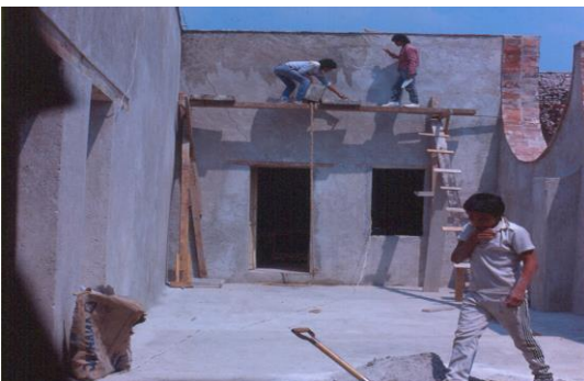
Figura 37 se puede observar cómo se están haciendo los aplanados en la planta alta de Casa Talavera. Fuente perteneciente al archivo fotográfico de Gilda Cano (1987).
