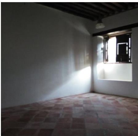
Figura 52 correspondiente a la zona restaurada en la segunda fase de restauración correspondiente al salón que se encuentra en el segundo patio de la Casa. Fuente perteneciente al archivo fotográfico de Jessica Mendoza (2021).
